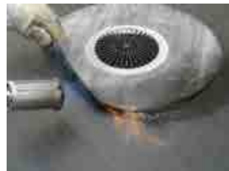
3. Prvi bitumenski sloj plamensko vezati na surov pod, bitumensko obrobo odtoka plamensko vezati na prvi bitumenski sloj
